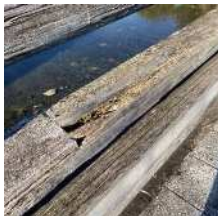
(図1) 腐食している高欄
