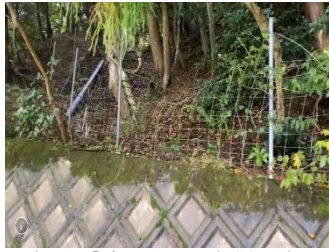
資料 1「破壊された防護柵(今里ゼミ 2020/10/22 撮影)」
